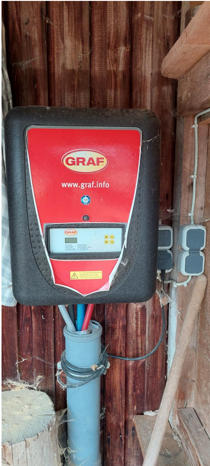
© IMBY – Steuergerät der Kleinkläranlage
