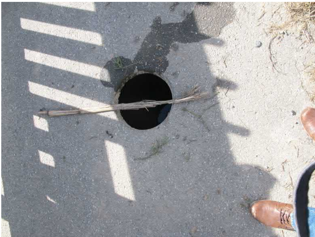
Abbildung 1: Situation am 25.02.2019; der Verbruch ist als kreisrunde Öffnung im Asphalt zu erkennen.
