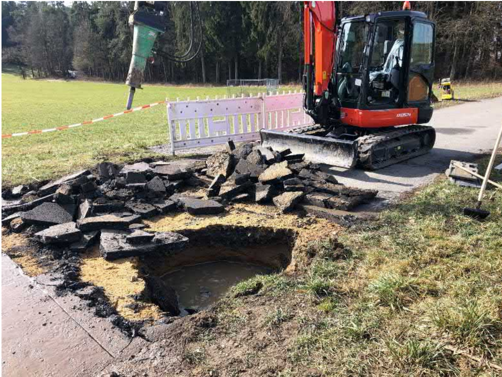
Abbildung 2: Situation am Verbruch nach dem Öffnen der Asphaltdecke. Das vollständige Ausmaß des Verbruches ist deutlich sichtbar.
