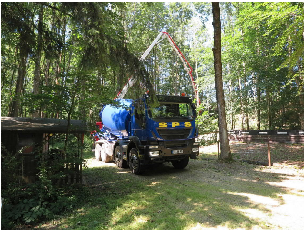
Abbildung 3: Die Hohlräume im Bereich der Schachtfüllsäule des Flachschachtes wurden ebenfalls mittels Beton und Dämmung verwehrt.
